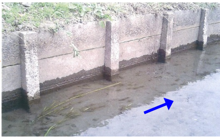
現況水路／老朽化／河床泥土化
